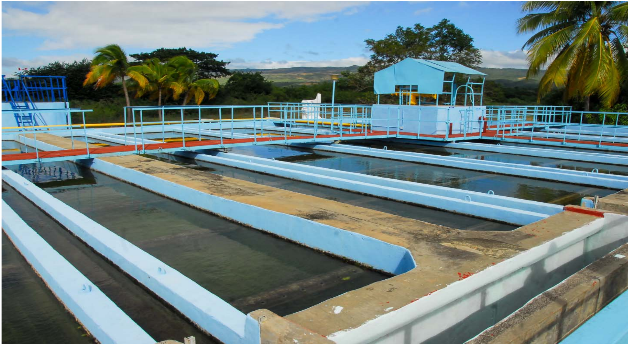
La planta potabilizadora Guaso fue inaugurada en 1983, y suministra agua desde el embalse Faustino Pérez a más del 60 por ciento de la población de la ciudad del Guaso, río homónimo que es su fuente de abasto.
